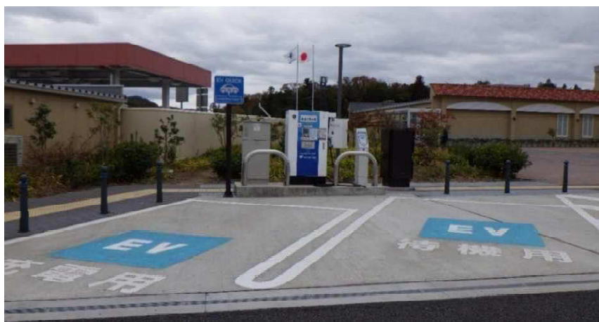
イ 急速充電設備の外観
