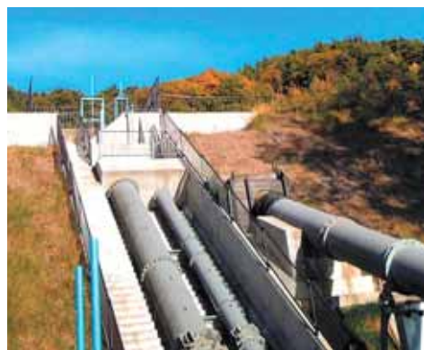
小水力発電施設「町川発電所」
