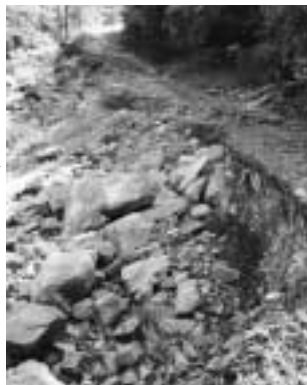
川下川ダムの 通路損壊
