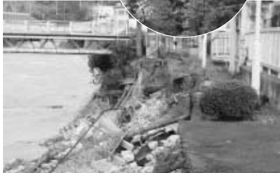
生瀬浄水場石積護岸の崩壊
