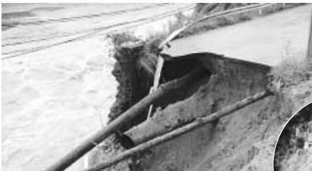
県道生瀬門戸荘線の崩壊
