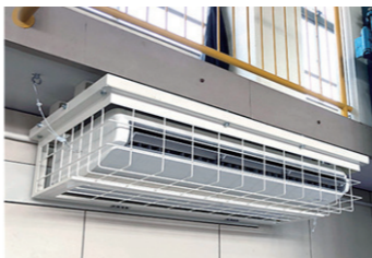
学校体育館 室内機 (イメージ)
