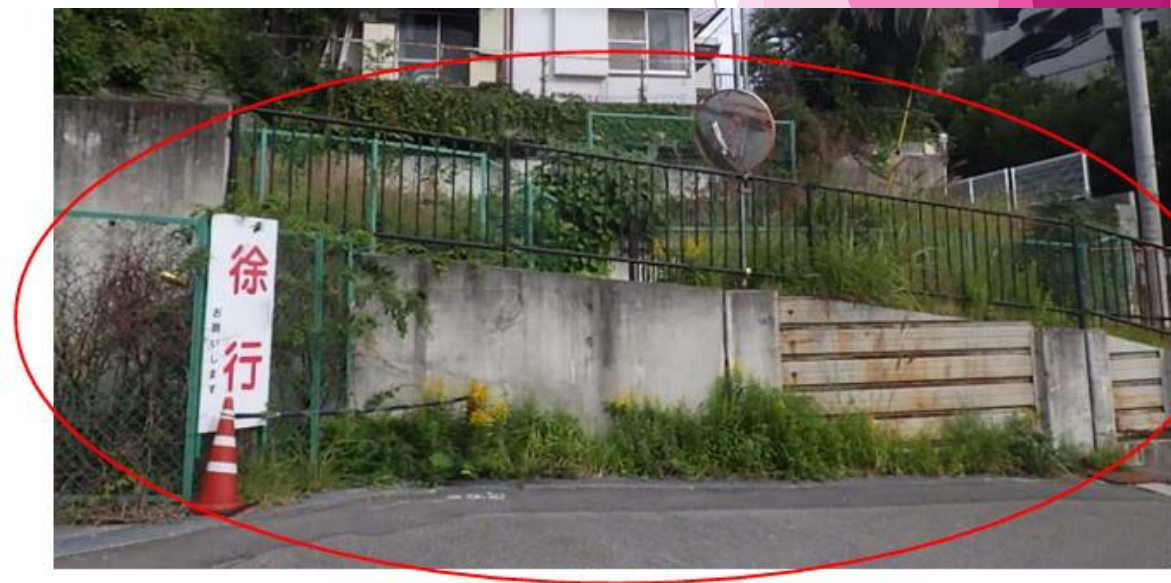
撤去が必要なコンクリート構造物
