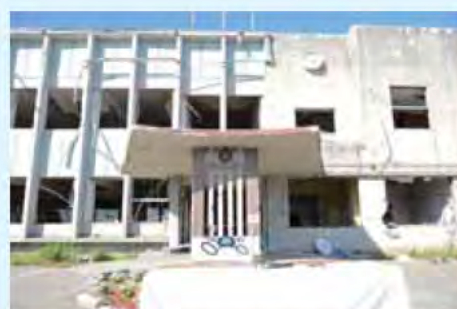
津波で全壊した庁舎
