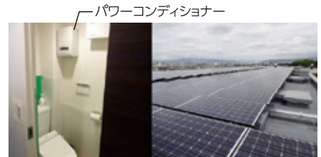
▲トイレの中にあるパワーコンディショナーからは、非常時に電気を取り出すことができます。 ▲100kW以上にもなる屋上の太陽光パネル(一般の戸建住宅の平均設置容量は約4kW)
