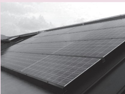
市立安倉中保育所屋上の太陽光パネル
