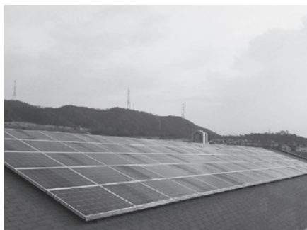
山手台小学校の太陽光発電パネル
