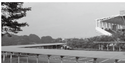
サッカースタジアム送迎バス発着場所に設置されたカーポート型太陽光パネル(静岡市)
