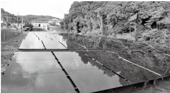
宝塚すみれ発電所第2号 太陽光パネルの下にクローバーを植え、周囲には低木の植樹が予定されています。
