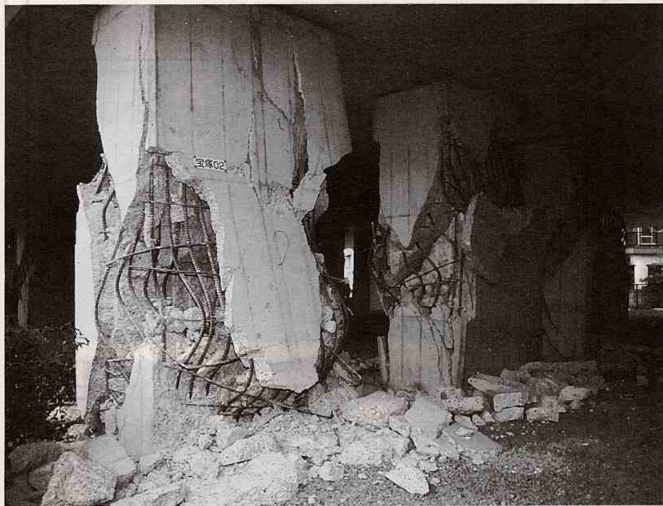
損壊した中国自動車道の橋脚(亮布3丁目)
