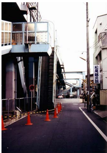
けたが落ちた歩道橋 売布3丁目
