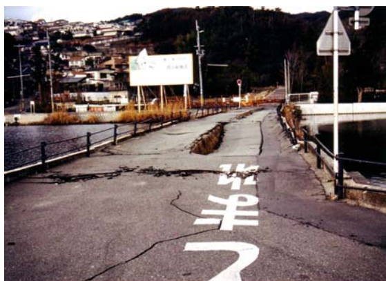
陥没した道路 売布4丁目
