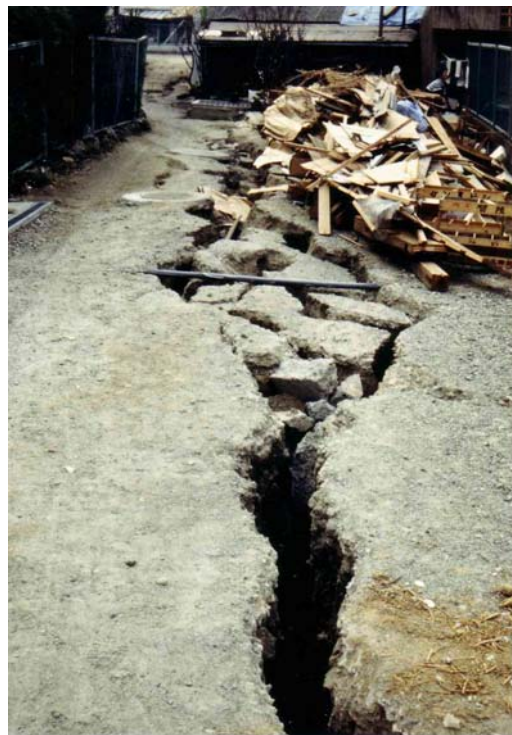
地震による地割れ 山本東2丁目
