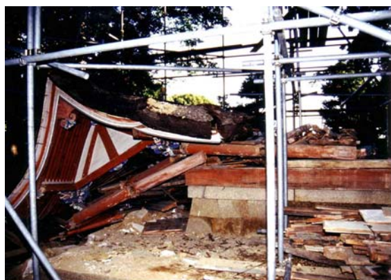
中筋 2 丁目の八幡神社。国指定重要文化財の本殿が倒壊
