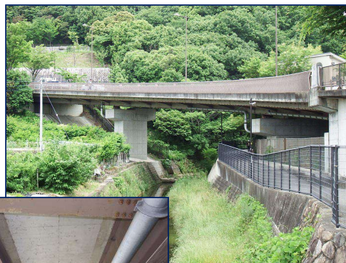
最明寺大橋(33歳) 健全性の判定区分Ⅱ
