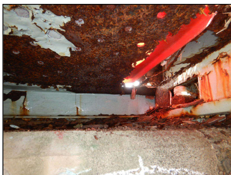
床版に腐食が見られます
