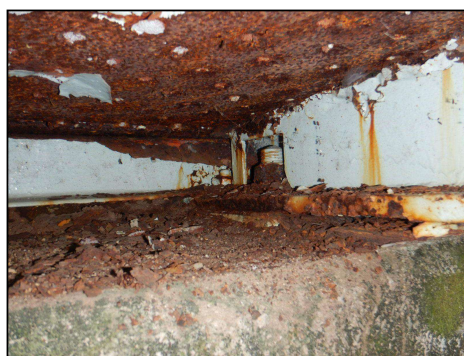
支承に腐食が見られます
