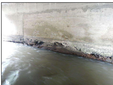
下部工に剥離・鉄筋露出が見られます
