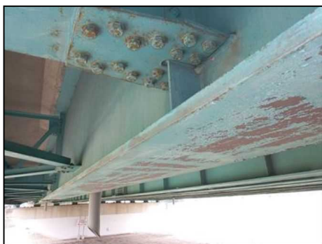
主桁に腐食が見られます
