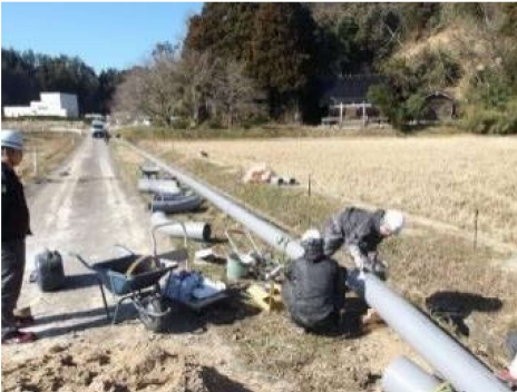
下水処理場に送る圧送管の被災（珠洲市）
