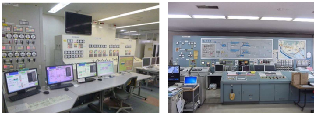
図 3-IV-7 浄水場の運転管理室
