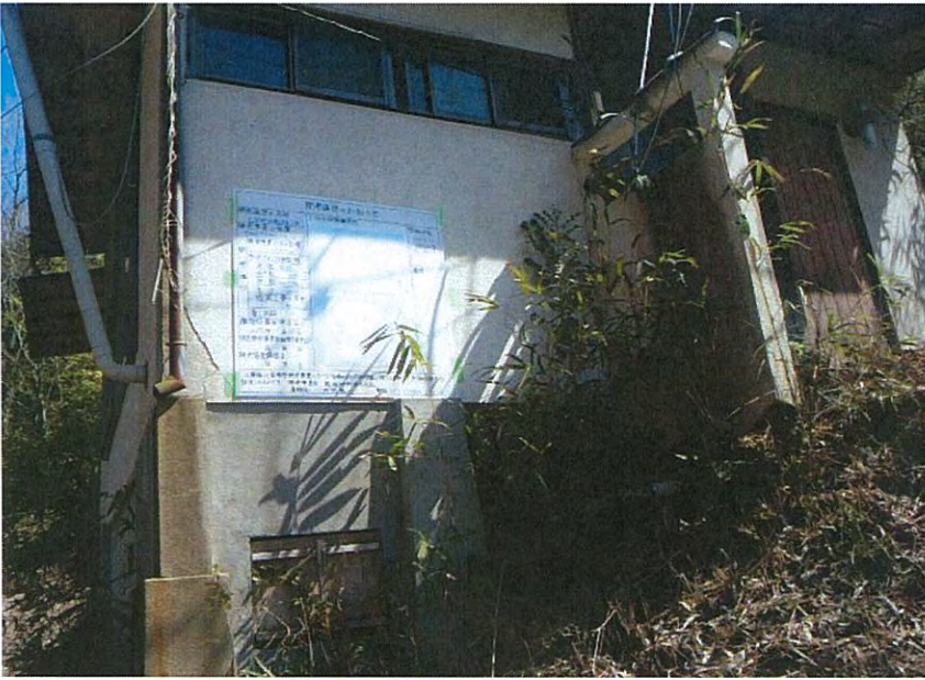
西向き 壁壁面に設置 (2)
