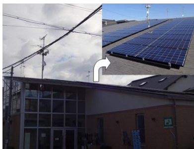
高松会館に設置された太陽光発電
