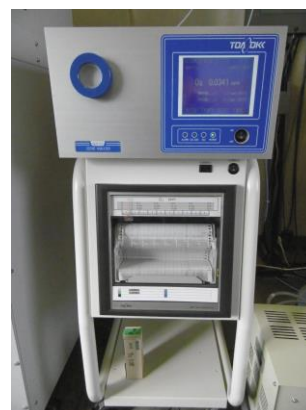
【図13】光化学オキシダント測定機 （よりあいひろば）
