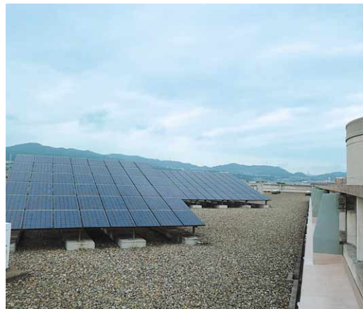
市庁舎屋上の太陽光発電設備
