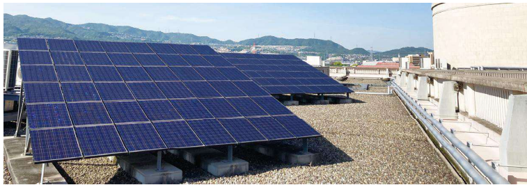
市役所屋上の太陽光発電 (30kW)
