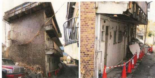
外壁・手すりが崩落した事例
