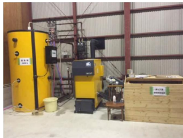
バイオマスボイラー
