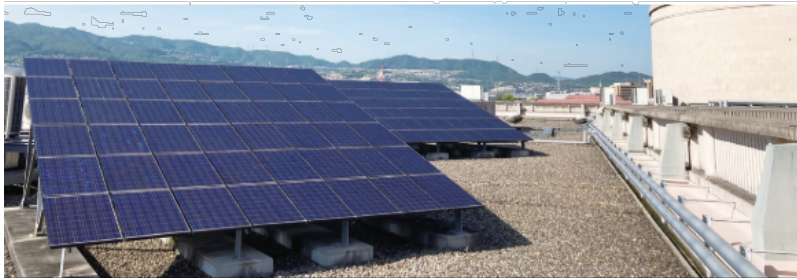
市役所屋上の太陽光発電（30kW）
