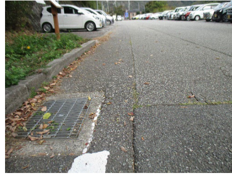
白線が消えている箇所
