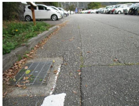
白線が消えている箇所
