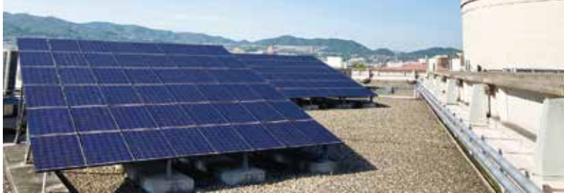
市役所屋上の太陽光発電（30kW）
