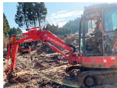
土砂災害現場(輪島市市ノ瀬町)での救出活動
