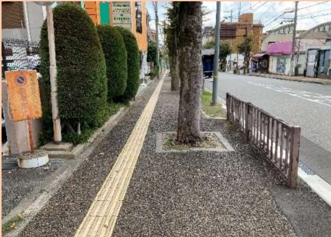
大木化+根系の肥大（植樹樹規格の限界） 根上り+歩道有効幅員不足 ⑤逆瀬川米谷線 ケヤキ
