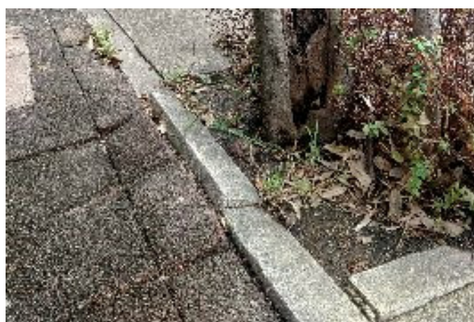
【根上りによる舗装の不陸】
