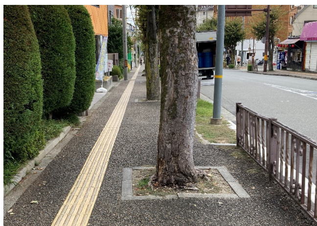
【歩道の有効幅員不足】
