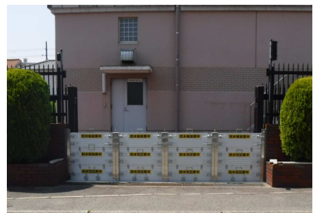
小浜浄水場 浸水パネル
