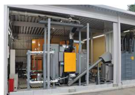
【バイオマスボイラー（神戸市）】
