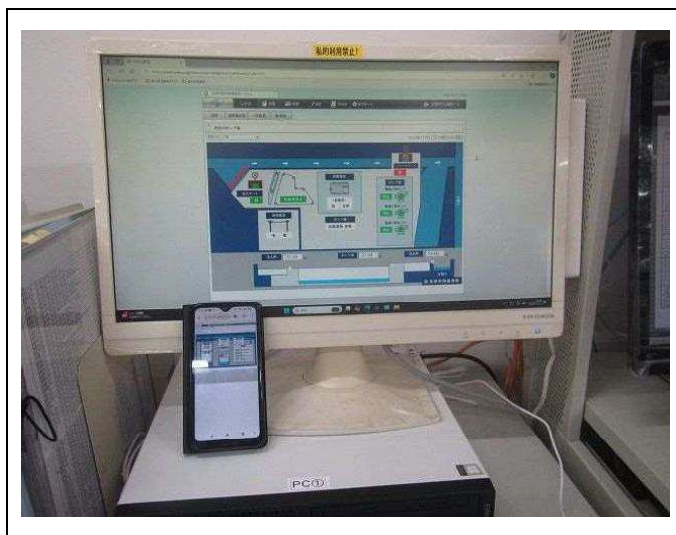
図 3-2-5 クラウド化した監視システム
