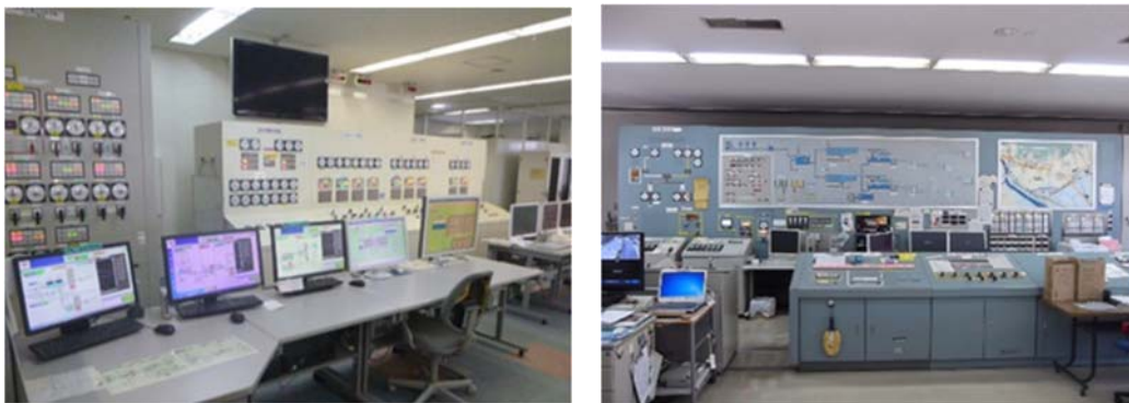
図 3-Ⅳ-7 浄水場の運転管理室
