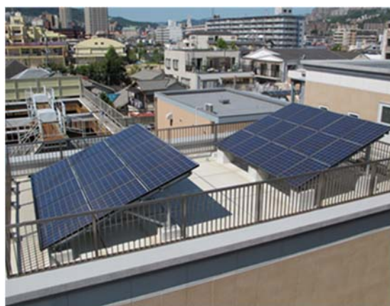
図 3-Ⅱ-7 小浜浄水場の太陽光パネル
