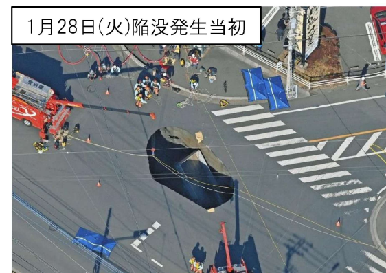
埼玉県の陥没事故の概況
