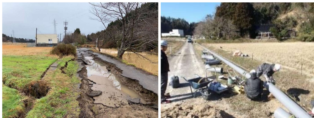
浄水場に送る導水管の被災(珠州市) 下水処理場に送る圧送管の被災(珠州市) (出典)国土交通省「令和6年能登半島地震における上下水道施設被害と今後の地震対策、災害対応の在り方」より
