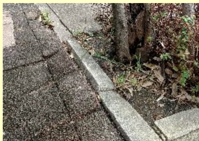
【根上りによる舗装の不陸】
