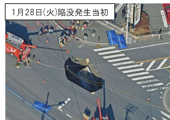
埼玉県の陥没事故の概況
