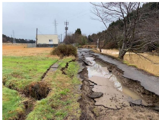
浄水場に送る導水管の被災(珠洲市)
