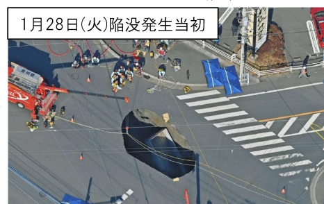
埼玉県の陥没事故の概況
