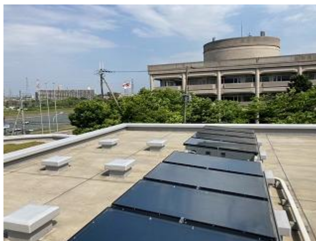
太陽光パネル（中央公民館）
