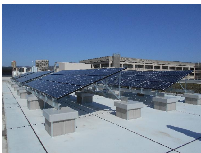
太陽光パネル（市役所第二庁舎）
