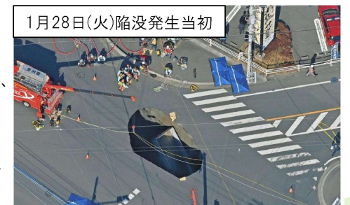
埼玉県の陥没事故の概況
