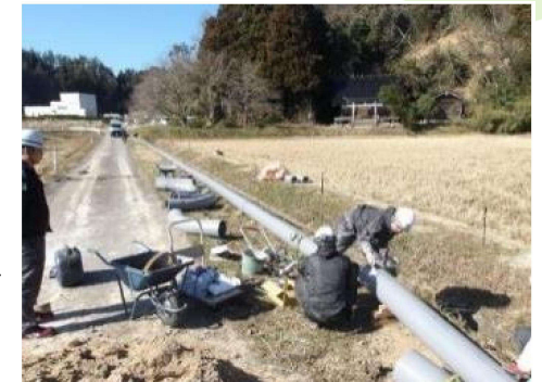
下水処理場に送る圧送管の被災(珠洲市)
