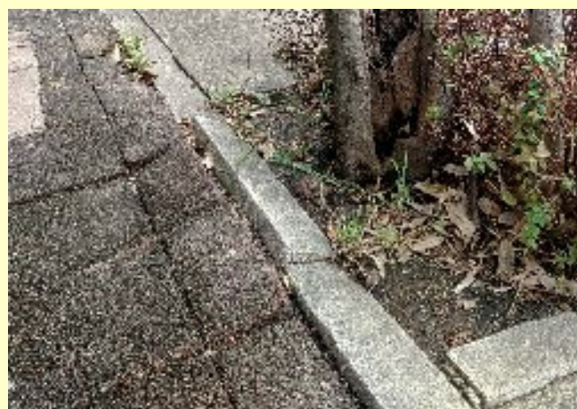
【根上りによる舗装の不陸】
