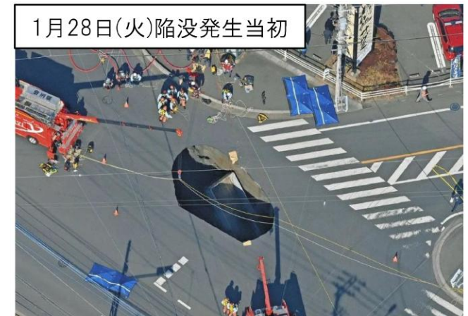
埼玉県の陥没事故の概況
