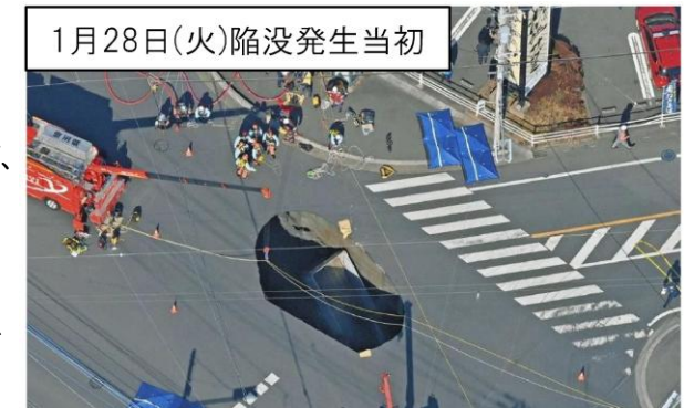
1月28日(火)陥没発生当初
