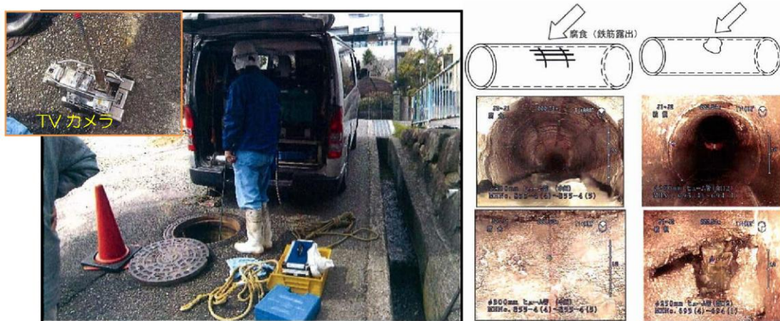
図 3-II-3 TVカメラ調査状況（左）、管内の劣化状況（右）
