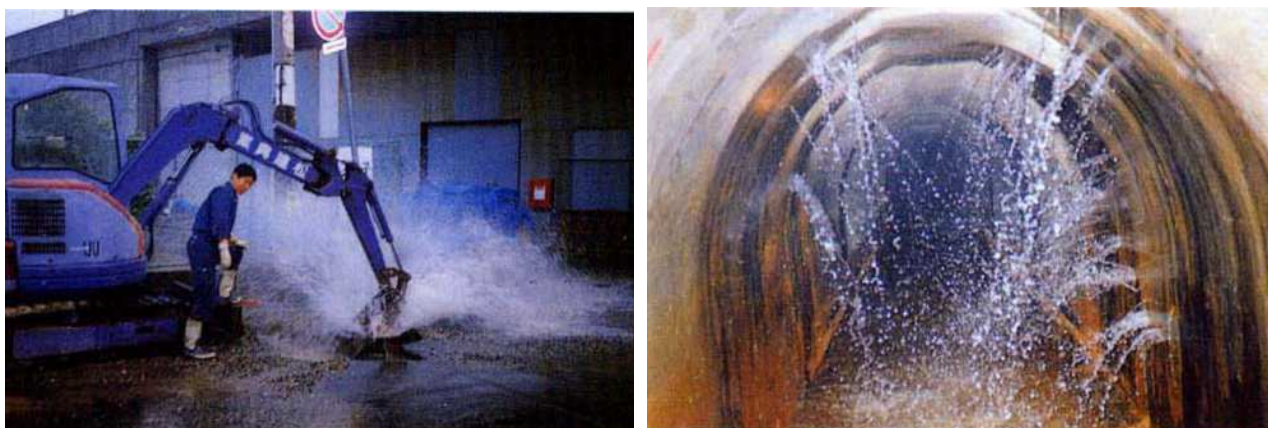
図 3-I-14 阪神・淡路大震災での被災状況 (左：配水管の破損、右：川下川貯水池導水トンネル異常湧水)
