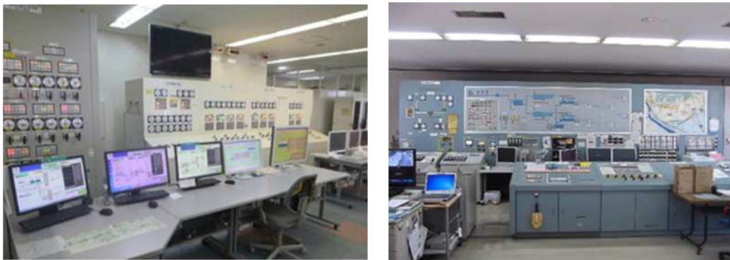
図 3-IV-7 浄水場の運転管理室
