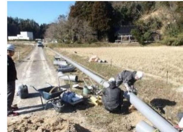
下水処理場へ送る圧送管の被災(珠洲市)
