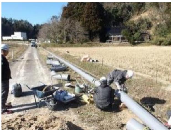
下水処理場に送る圧送管の被災(珠洲市)
