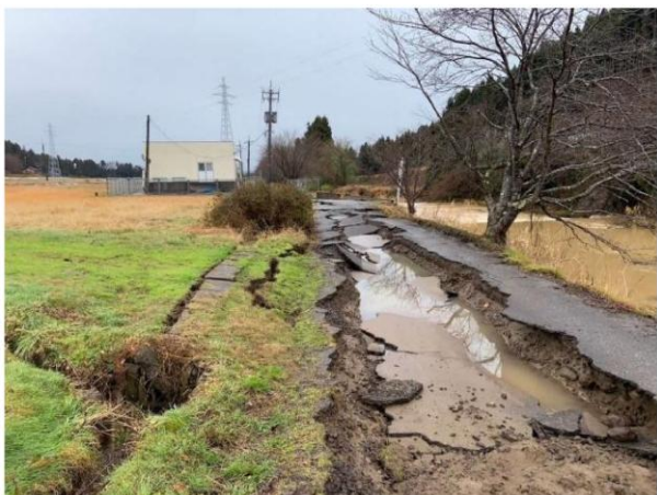
浄水場に送る導水管の被災(珠洲市)
