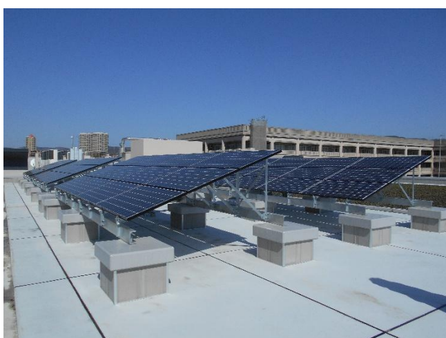
太陽光パネル（市役所第二庁舎）
