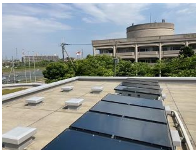
太陽光パネル（中央公民館）
