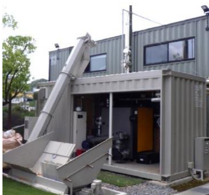
木質バイオマスボイラー
