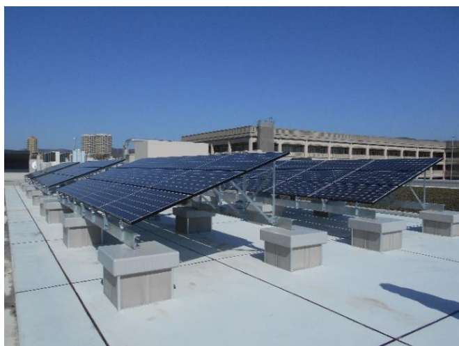
太陽光パネル（市役所第二庁舎）
